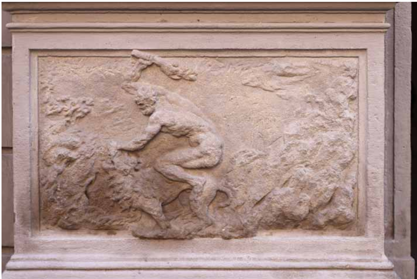
Reliéf pravého portálu Clam-Gallasova paláce před aplikací fasádního nátěru, foto © Martin Mádl
